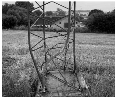
Gittermast efter påkørsel.
