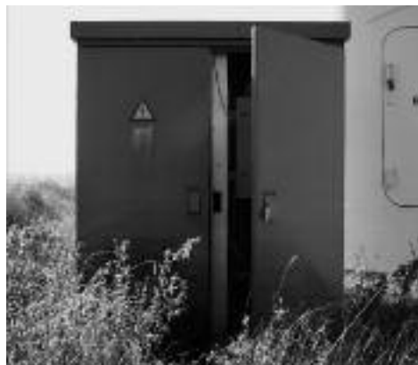
Transformerstation ved vindmølle i Bregninge, som nu er historie.
