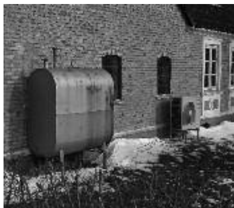
Varmepumpe som oliefyr og olietankens afløser.
